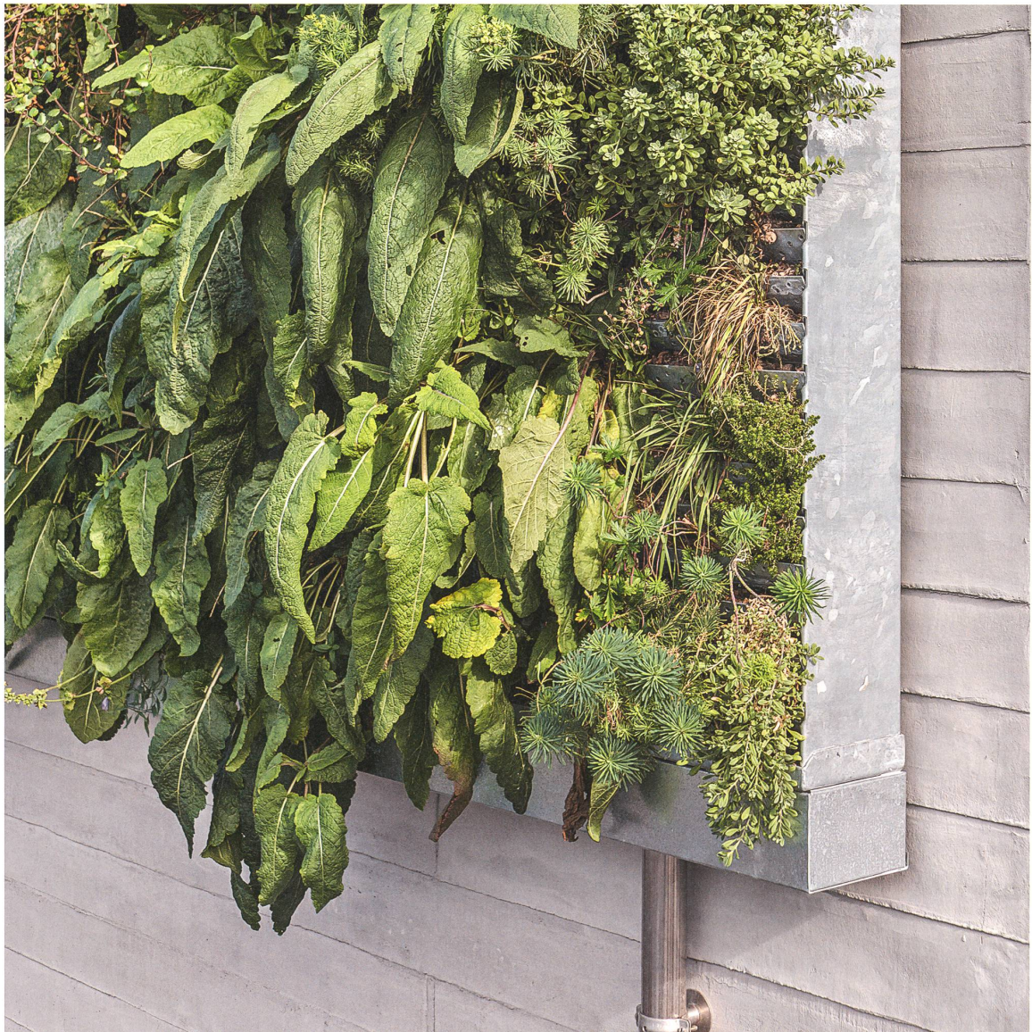
Bei Hors-sol-Systemen wachsen Pflanzen aus modularen oder flächigen Wandelementen, wie hier aus Metallkassetten mit integrierter Bewässerung. Bilder: Johannes Marburg
