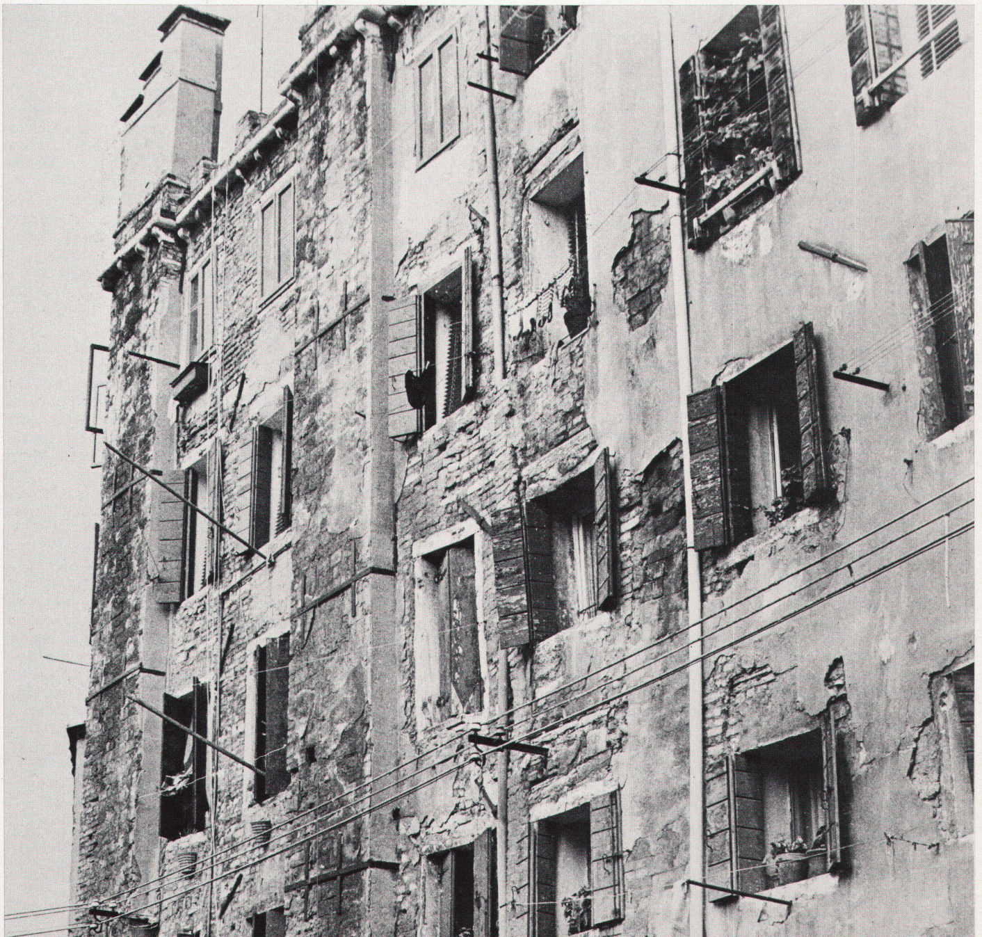
Fortgeschrittener Zerfallzustand der Bausubstanz (Foto: Alessandro Zen, Venezia).
