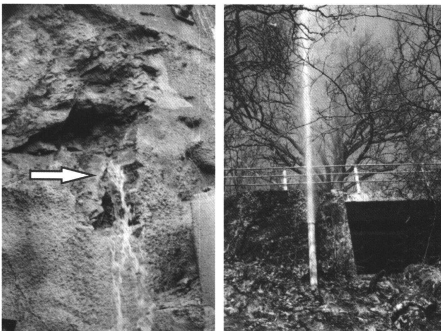
Fig. 10: Druckversuch vom 24.-25. April 1990: Aus dem Sondierstollen ausgepresste Wasser-Luft-Fontäne (links). Druckversuch vom Herbst 1989: Unkontrollierte Wasseraustritte aus der Ankerwand beim Ostportal des Ligerztunnels (rechts).
