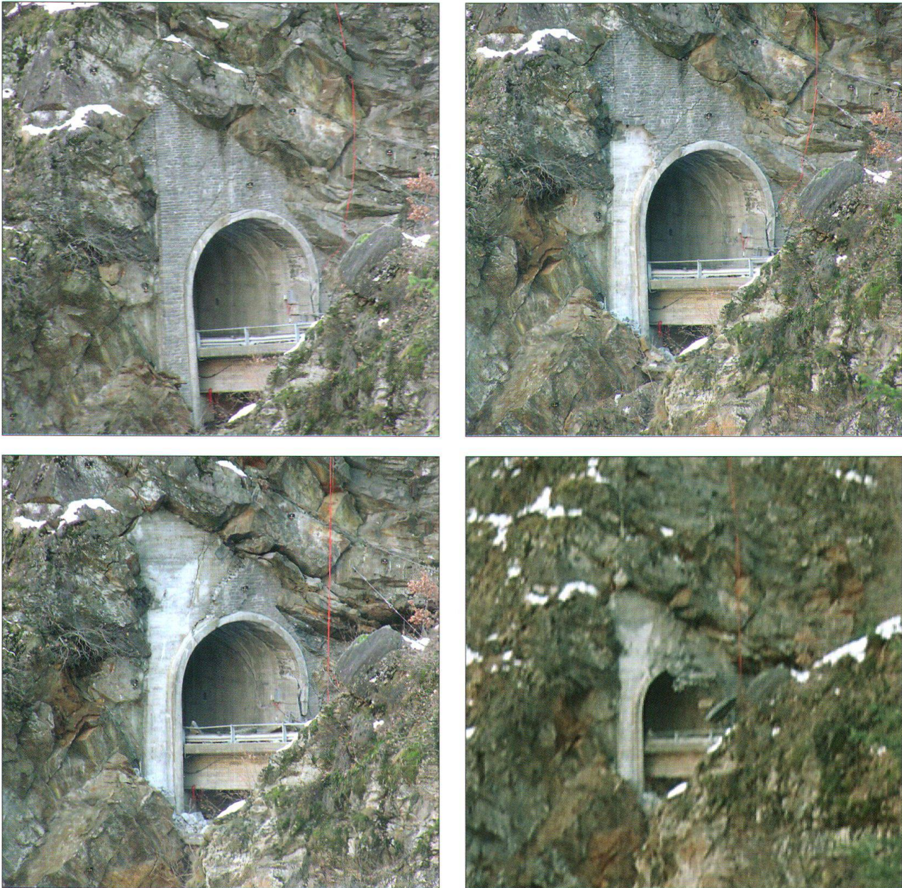
Fig. 7: Das Tunnelportal wurde innerhalb der letzten 3 Stunden stark deformiert [Zeitpunkt vor dem Absturz: oben links 2\frac{3}{4} h, oben rechts 1\frac{1}{2} h, unten links \frac{3}{4} h, unten rechts \frac{1}{2} h].
