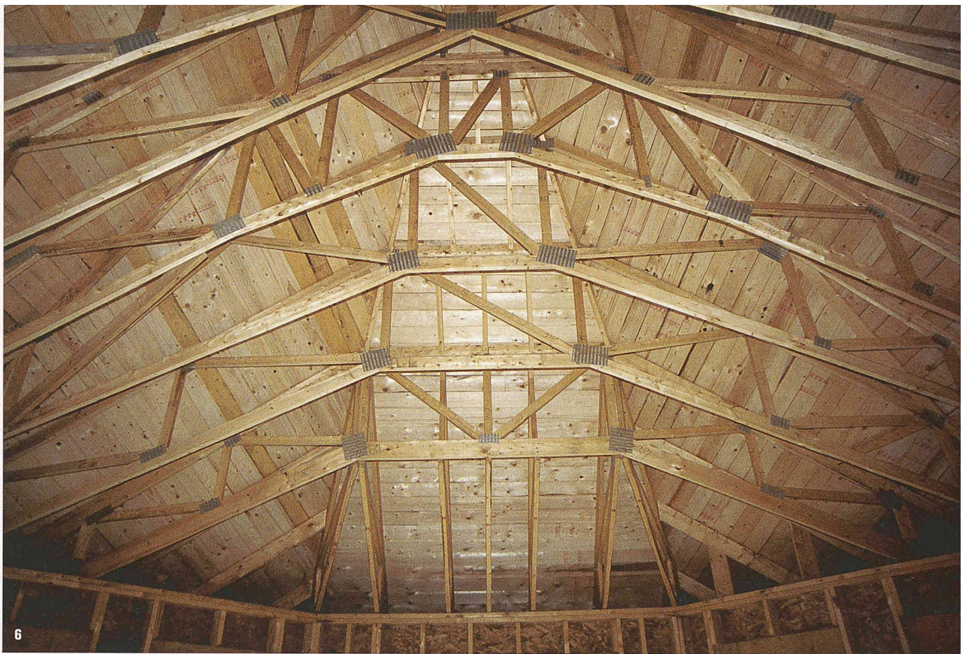
6 Nagelplatten-Dachbinder im Wohnzimmer eines Einfamilienhauses. Da das Dach in kanadischen Häusern normalerweise nicht ausgebaut wird, kann der Dachraum für diese sehr leichte und effiziente Tragkonstruktion genutzt werden
