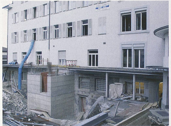
Ein angebauter Liftkern aus Stahlbeton verbessert die Erdbebensicherheit an einem Schulhaus in Monthey VS (Bild: Wenk)
