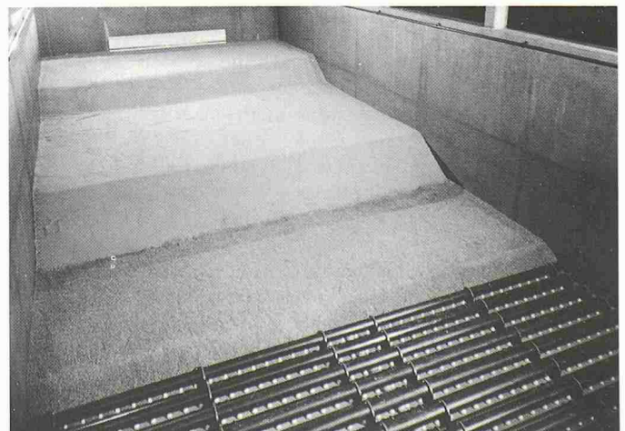
Bild 3. Blick in Drainagefilter 87
