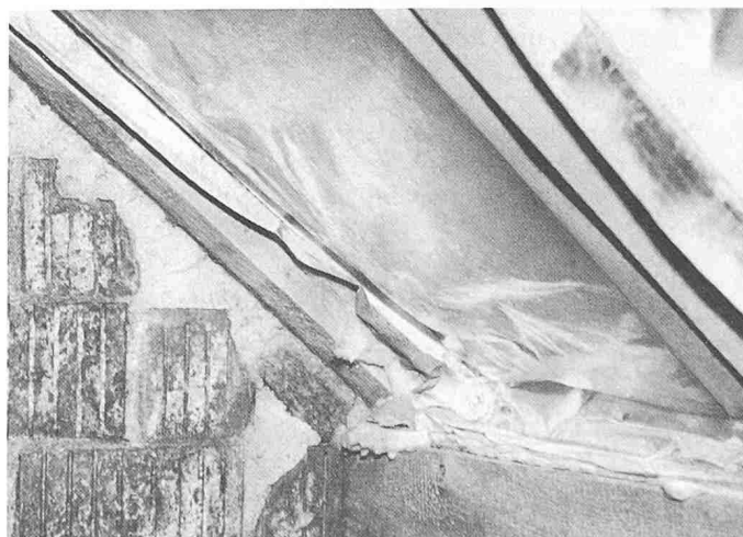
Bild 3. Nicht luftdichte Anschlüsse bei Sparren und Schwelle
