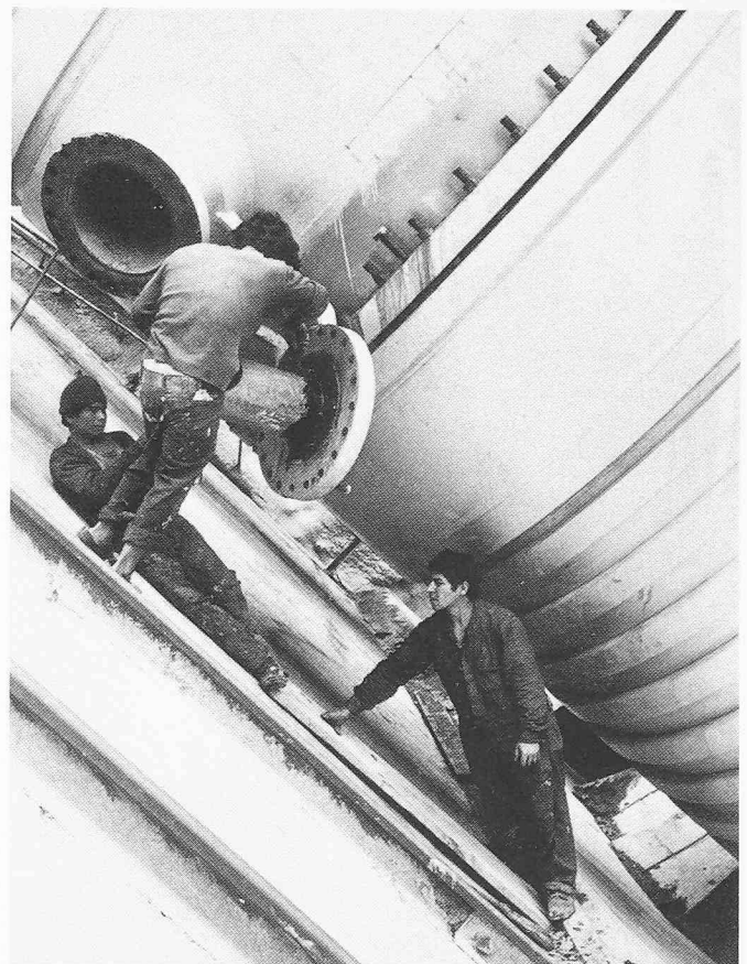
Bild 10. Das Ein- und Aussteigen durch dieses ohnehin zu enge Mannloch ist hier besonders schwierig. Ein gefahrloses Arbeiten an der Druckleitungsexpansion (z. B. Nachziehen der Schrauben über den ganzen Umfang oder Auswechseln der Dichtungsschnüre) ist unmöglich
