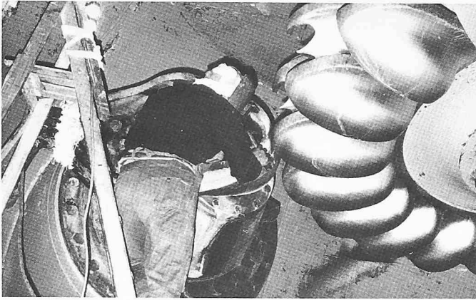
Bild 24. Arbeiten im Innern einer Pelton turbine mit unzulässigen, improvisierten Beleuchtungseinrichtungen von 220 Volt; Einrichtungen für Kleinspannung fehlen hier
