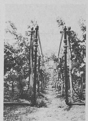
Unirac-Fittings und Kugelhahn Typ 349, installiert in einer Tropfbewässerungsanlage eines Weinberges
