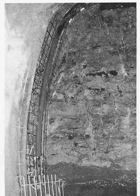
Bild 6. Tunnelausbau in NATM mit Tunnelbogen aus Stahl zur Stützung der Kalotte und mit Spritzbetonauskleidung bewehrt mit Betonstahlmatten
