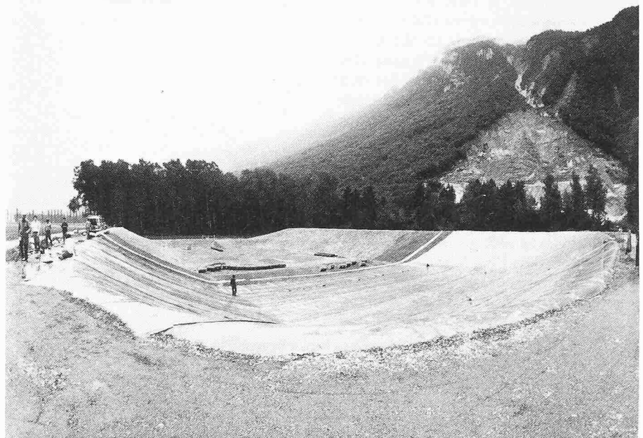
Bild 11. Blick auf die mit Kunststoffdichtungsbahnen fertig abgedichtete erste Etappe der gesicherten Deponie in Collombey-Muraz
