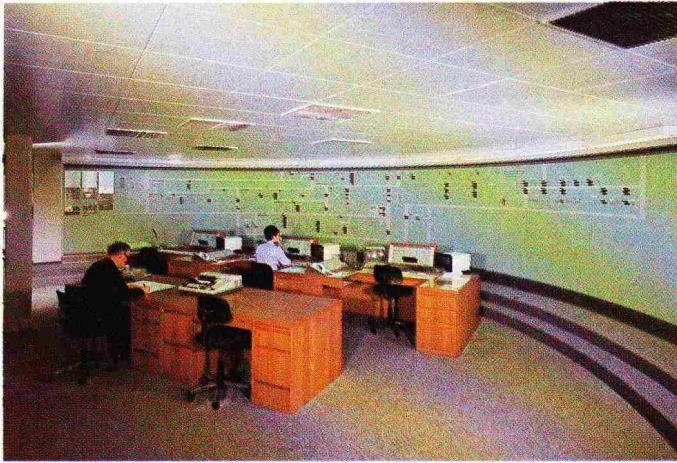
Bild 2. Blick auf die Panoramatafel im Fernsteuerzentrum Zürich Oerlikon
