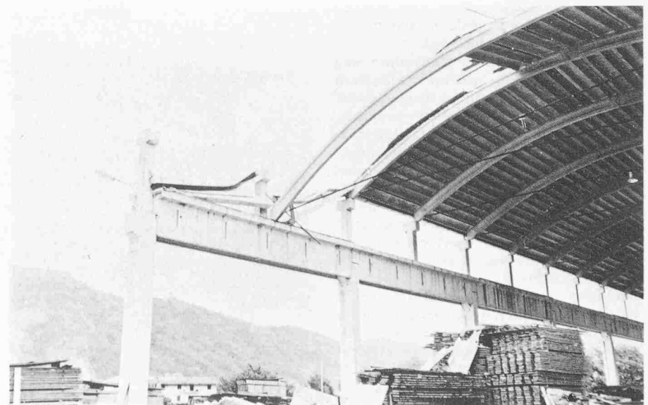
Schäden an einer Lagerhalle in Magnano als Folge des Friaul-Erdbebens vom 6. Mai 1976. Das äusserste Dachsegment ist vollständig heruntergestürzt. Der zweite Dreigelenkbogen fiel nur bis auf den Längsträger hinunter. Der Schaden ist primär durch die knappen Auflager der Dachelemente bedingt
