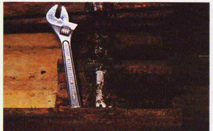
Bild 12. Geöffnete Überlappung mit Überresten eines Dichtungsbandes. Sehr starke Korrosion bis zur Perforation im Bereich der Überlappung
