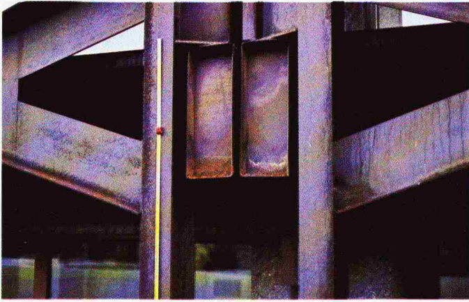
Bild 1. Fassadenausschnitt, Stahlskelettbau mit zahlreichen Stellen, wo das Regenwasser längere Zeit liegen bleiben kann
