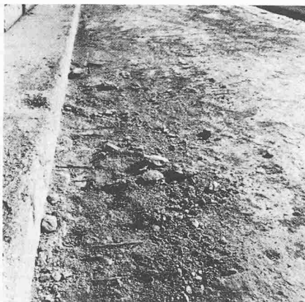
Bild 4. Frost- und Tausalzschäden des Fahrbahnbetons. Zustand der Betonbrückenplatte nach der Entfernung des Bitumenmörtelbelages.
