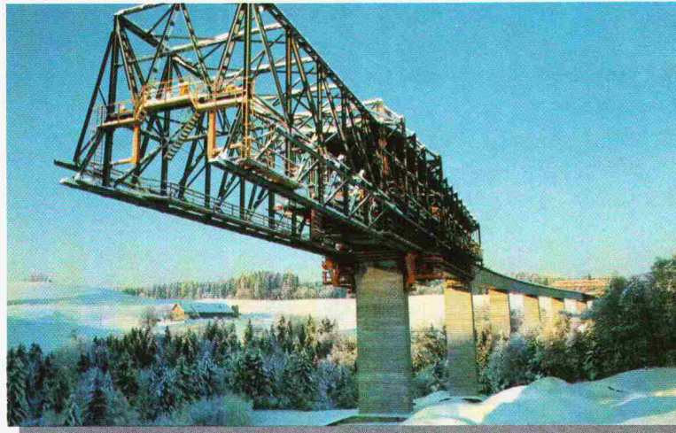
Viadukt am Greizersee der N12 im Kanton Freiburg Projekt und Ausführung: Die Arbeitsgemeinschaft mit den Ingenieuren: B. Bernardi, Zürich I. C. A., Freiburg E. + A. Schmidt, Basel und den Unternehmungen: Losinger AG, Freiburg Antiglio AG, Freiburg
