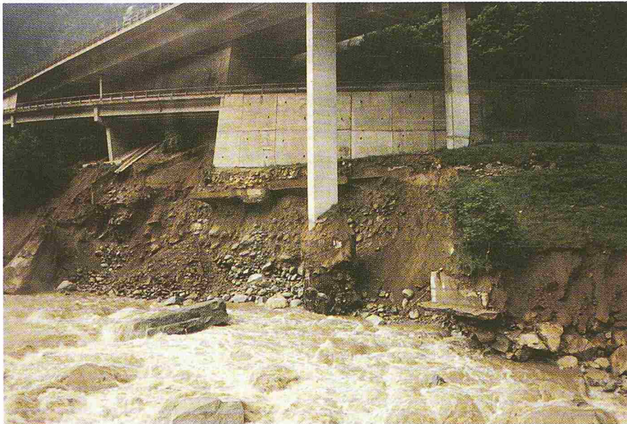
Bild 4. Absenkung Reussbrücke und freigelegte Fundationen von Pfeiler I und Stützmauer der Kantonsstrasse Bildautor: T.R. Schneider
