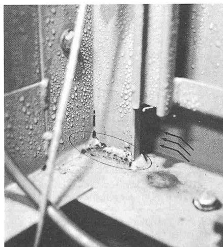
Bild 6. Kondenswasserbildung und Verschimmelung im Fussrahmen eines Apparateschranks
