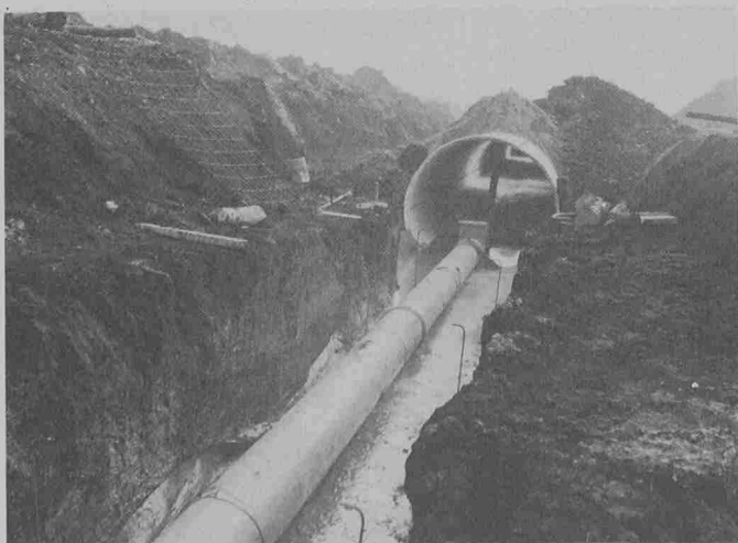
Einbetonierte PVC-Leitung in Armco-Rohr
