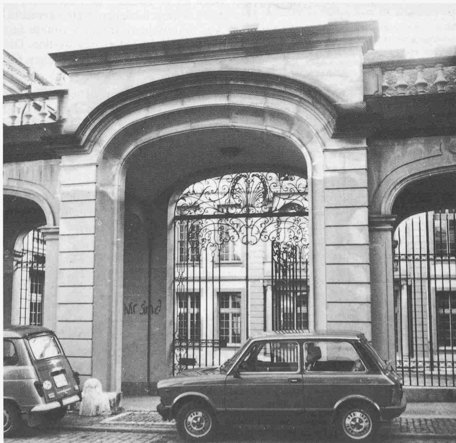
Bild 1. Teilansicht des Laubentraktes Erlacherhof: Eingangstor mit Blick gegen Hof. An den Bogenansätzen und darüber sind Salzausblühungen und -krusten als weisse Schleier erkennbar
