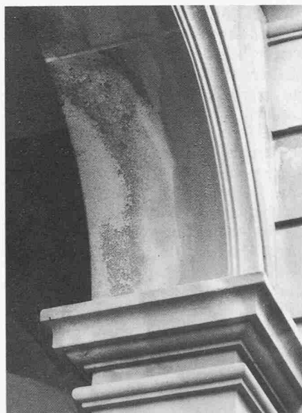
Bild 3. Detail eines Bogenansatzes mit Salzkrusten und -ausblühungen. Die rechte Pfeilerkante wird vom Regen und oberflächlich abfließendem Sickerwasser benetzt. Links davon zonare Anreicherung von Gipsausblühungen (heller Striemen Mitte Bogenlaibung) und Magnesiumformiat-Krusten (entlang linker Kante), wo der Stein intensiv absandet
