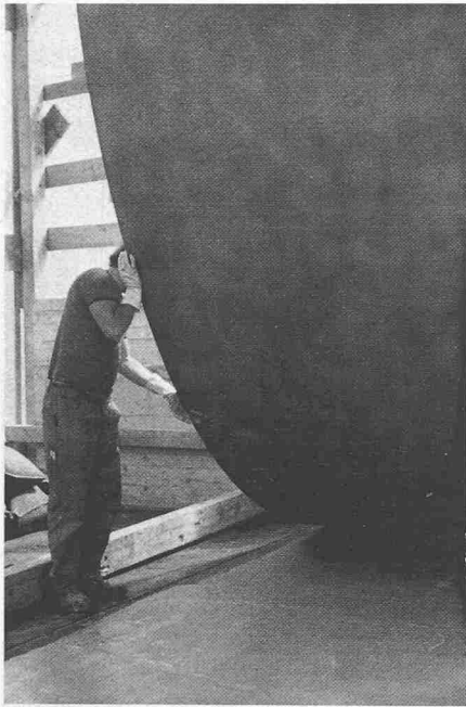
Bild 13. Aufkleben von 8 m 2 grossen Stahlblechen als Strahlenschutz für die Steuerorgane des Zonenpumpwerkes Hardhof in Zürich
