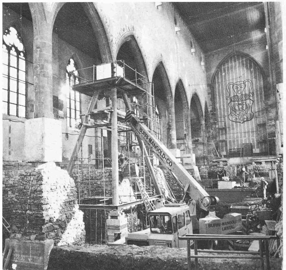
Bild 8. Pfeiler B 4 ist unterfangen und bis auf das Fundament abgetragen. Im Gegensatz zu den Pfeilern der Achse C ruhten diejenigen der Achse B auf massiven Einzelfundamenten. Im Hintergrund erkennt man die provisorische Schutzwand zwischen Chor und Mittelschiff (Aufnahme 29.1.76)
