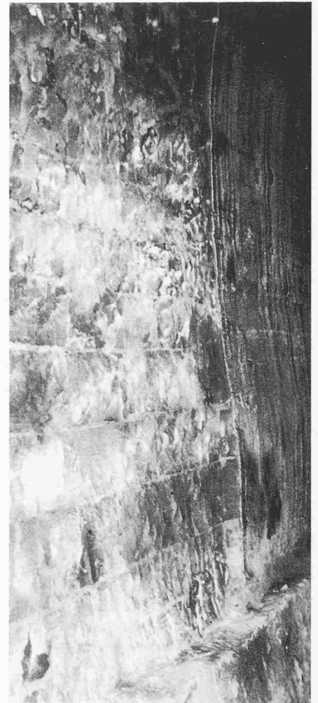
Bild 4. Widerlager mit Sägeschnitten vor und nach dem Abschlagen der durch die Sägeschnitte entstandenen Steinrippen
