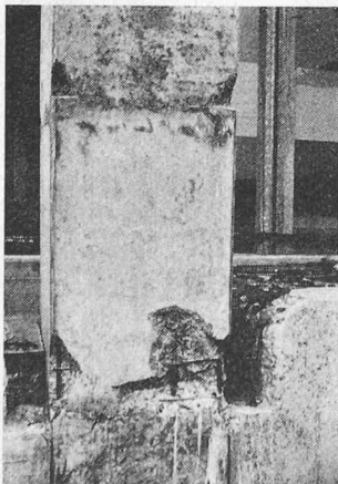
Bild 14 (nach dem 15. Sept.). Stützenfuss der Möbelfabrik Fantoni in Rivoli di Osoppo. Mit der Reparatur des durchrissenen Stützenfusses wurde eine Wiederherstellung der ursprünglichen Tragfähigkeit angestrebt. Die erneute Bebenbelastung bewirkte gleichartige Schäden wie beim ersten Erdstoss, die reparierten Einspannstellen der Stützen wurden neu durchrissen, und der Beton platzte in den höchstbeanspruchten Bereichen ab
