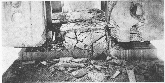
Bild 23. Autobahnbrücke mit 32 Feldern über den Tagliamento. Auflager der vorfabrizierten Träger auf massiven Pfeilerscheiben. Betonabplatzungen an den Trägern und vollständig zerstörte Auflagerkonsole infolge Anpralls des durch das Beben beschleunigten Trägers. Linker Brückenträger vom Auflager abgerutscht
