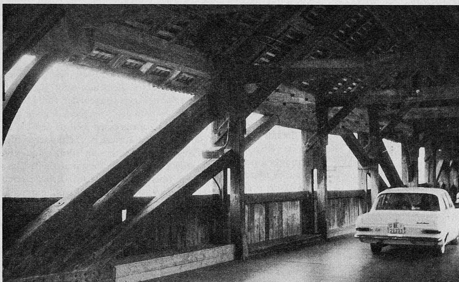
Bild 3. Säckingen: Dritte Öffnung vom Schweizer Ufer her. Links unten Eisen-Lasche der Zugstangen, oben mit Dachpfette verdübelter Riegel des Hängewerkes
