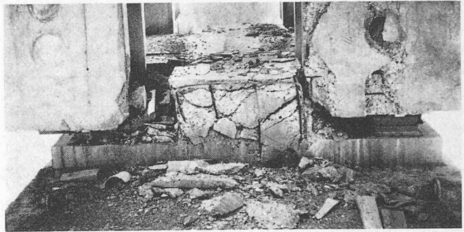
Bild 23. Autobahnbrücke mit 32 Feldern über den Tagliamento. Auflager der vorfabrizierten Träger auf massiven Pfeilerscheiben. Betonabplatzungen an den Trägern und vollständig zerstörte Auflagerkonsole infolge Anpralls des durch das Beben beschleunigten Trägers. Linker Brückenträger vom Auflager abgerutscht
