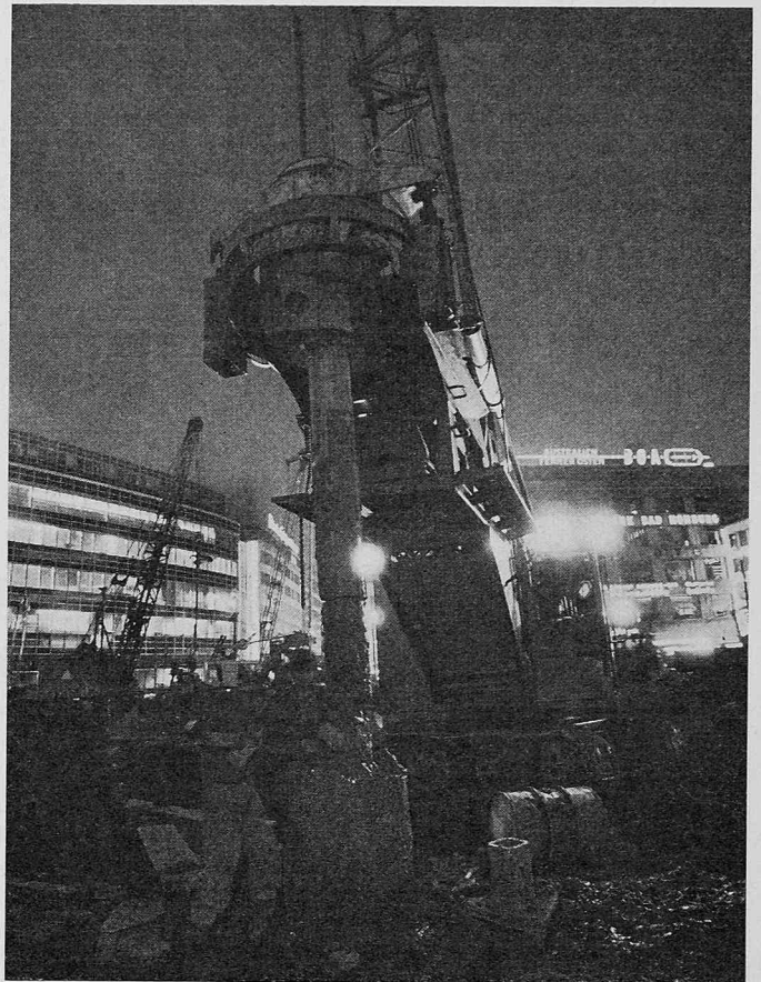
Bild 4. Bohrarbeiten mit einem Calwell-Gerät am Platz «An der Haupt- wache» in Frankfurt am Main. Photo K. Meier-Ude, Frankfurt. Alle übrigen Photos Bildarchiv des Frankfurter Stadtbahnbauamtes
