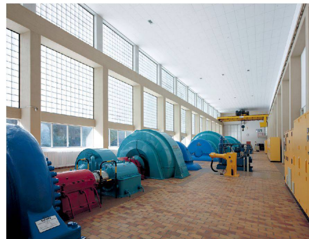
^EWZ-Kraftwerk Löbbia. ^Centrale elettrica EWZ di Löbbia.
