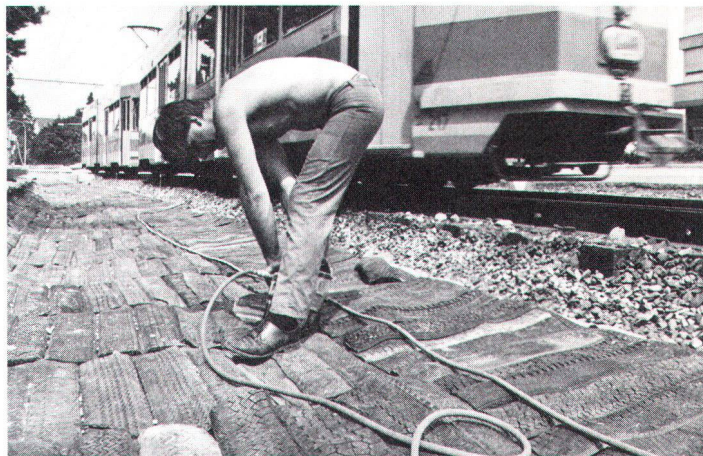
A Münchenstein BL, des pneus de voitures usagés front un coussin anti-bruit sous les voies de tram.
