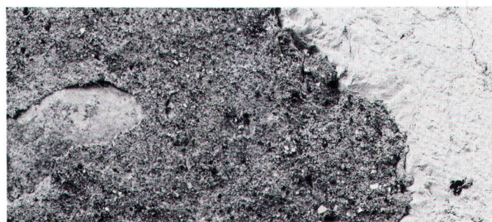
Détail d'un crépi ancien à la chaux en pâte. On remarque l'«accrochage» harmonieux du mortier à la pierre (photo Baertschi).
