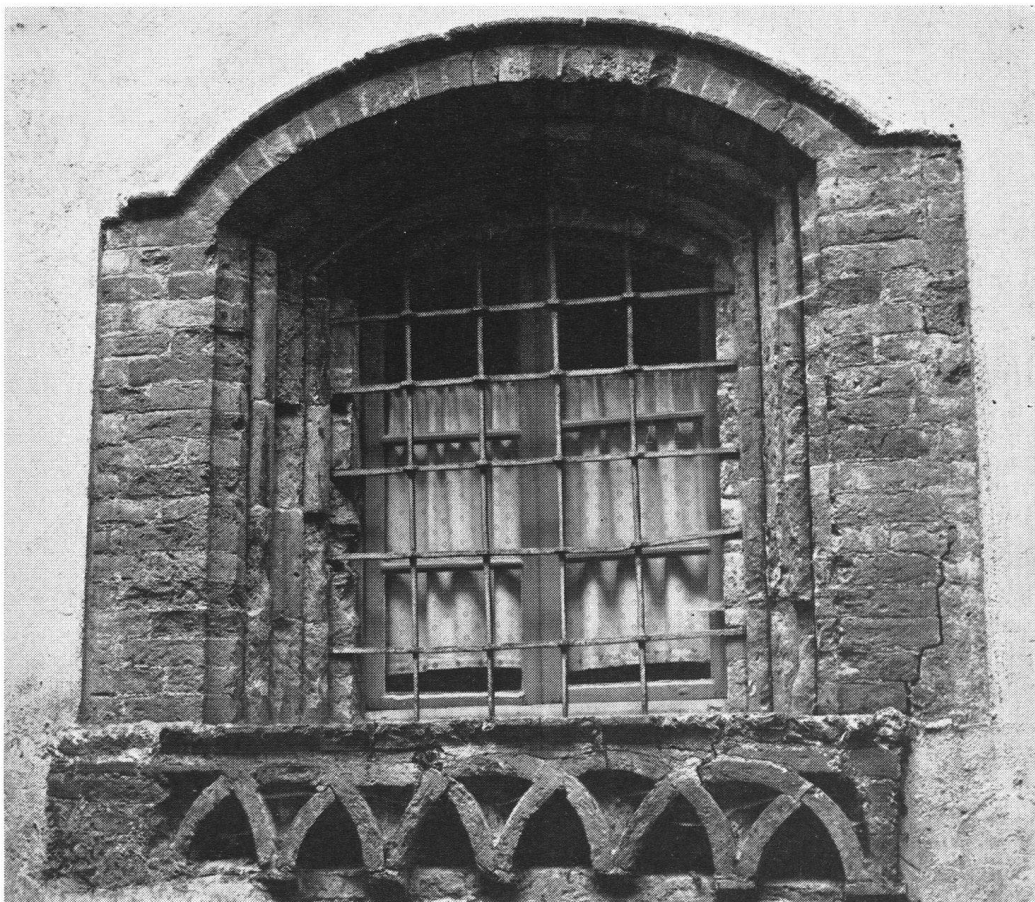
Dieses einzigartige Fenster am Hause Zanzisella gehört zu Morcotes Kunstkleinodien. Es ist ein Beispiel lombardischer Architektur, wie es im Tessin selten zu finden ist, und bedarf dringlicher Sicherung.
