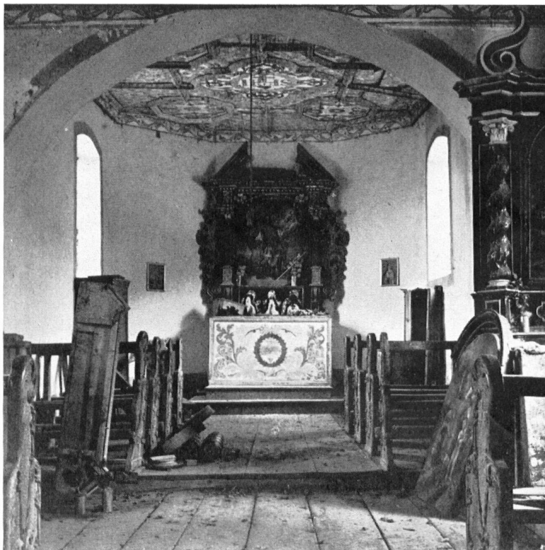
Das schöne Innere schien dem rettungslosen Zerfall entgegen zu gehen, durch die reichgemalte Decke trüfelte das Regenwasser, und die faulenden Bretter drohten herunterzustürzen.
