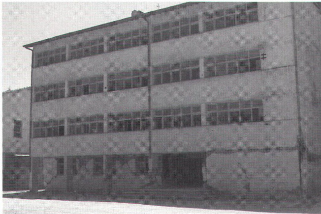
Abb. 1: Stark beschädigtes Gebäude (Schulhaus) in Dinar.
