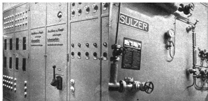
Elektro-Dampfkessel mit Verteilerraum und Kondensgefäss
