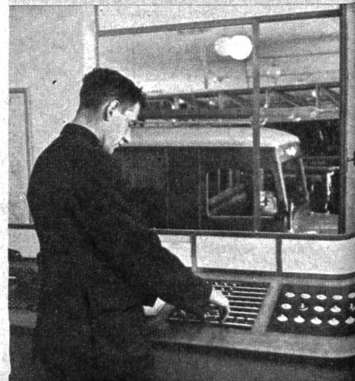
Hier wird Alarm gegeben, wenn eine Feuermeldung kommt
