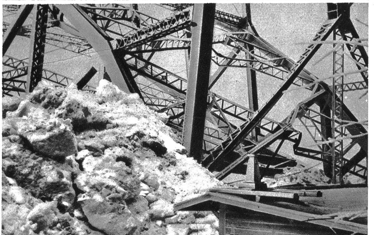
Die Eismassen an den Fundamenten der Brücke
