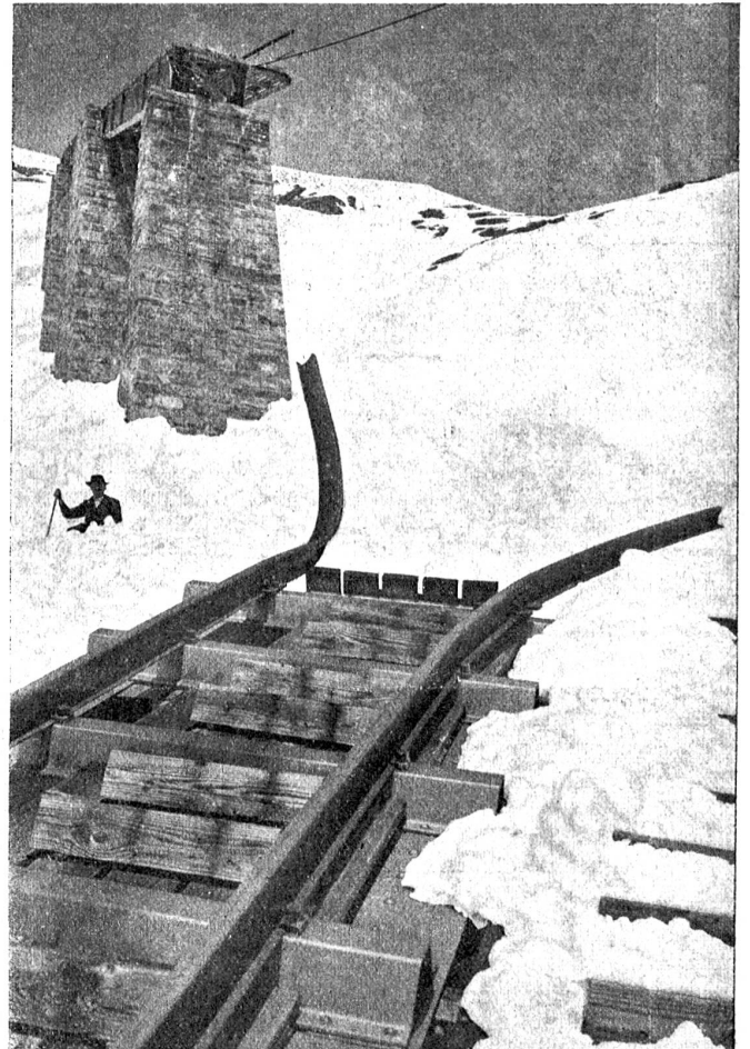
Der durch Schneerutsche eingestürzte oberste Viadukt der Niesenbahn. (Phot. G. Schneiter in Thun.)
