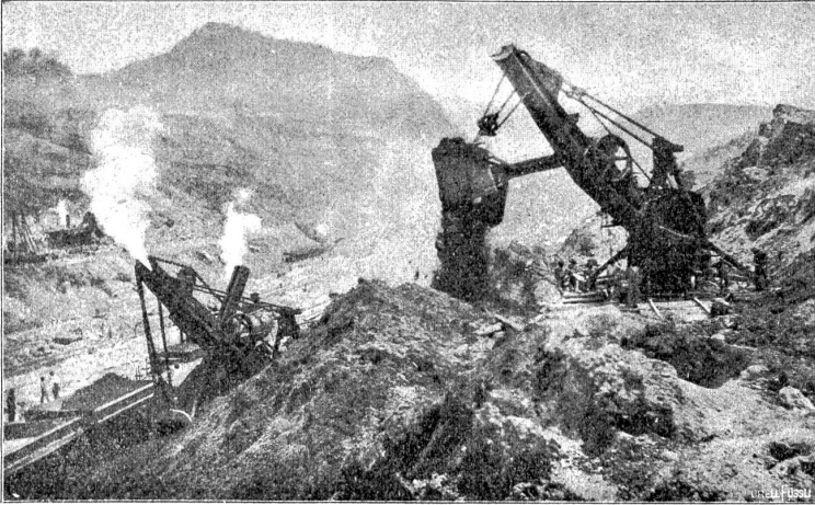
Dampföffelbagger im Culebra-Einschnitt, im Begriffe eine Rutschung wegzuräumen und provisorisch abzulagern zur Bedienung den tiefer stehenden, den Materialförderzug ladenden Dampföffelbaggers. Oktober 1912.
