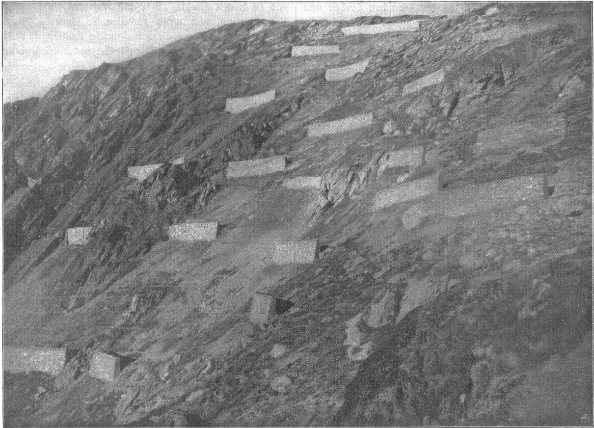
Lötschbergbahn: Die Lavinenverbauungen bei Goppenstein.
