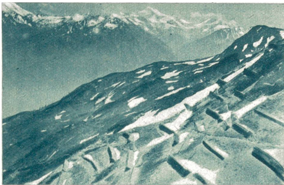
Lawinen-Verbauung auf der Faldum-Alp, oberhalb Goppenstein. Viele Hunderte solcher Mauern sollen die Lawinen-Anfänge schon oben aufhalten.
