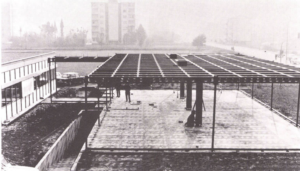
Ufficio Strada Nazionale , 6500 Bellinzona, Architekt G. Messi, 6500 Bellinzona. Nach zwei Jahren drängte sich bereits eine Erweiterung auf.
