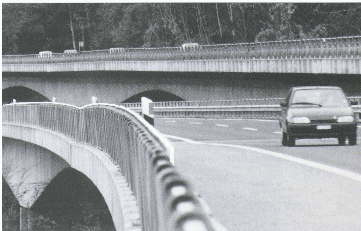
Fig. 17. – Viaducs de Chillon: discontinuité de la tangente résultant des déformations angulaires
