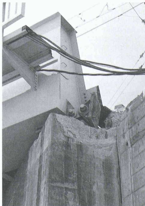
Fig. 13. – Rupture de l'appui horizontal d'un pont de chemin de fer
