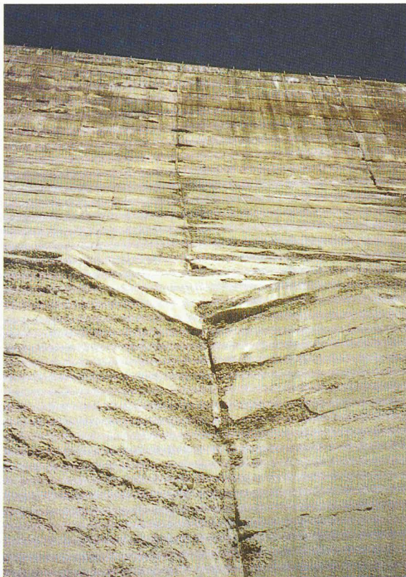
Fig. 3. – Etat de la partie supérieure des contreforts avant les travaux
