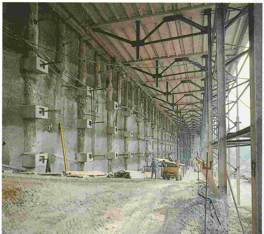
Fig. 5. – Paroi berlinoise et structure provisoire supportant la nouvelle chaussée de la route des Alpes.
