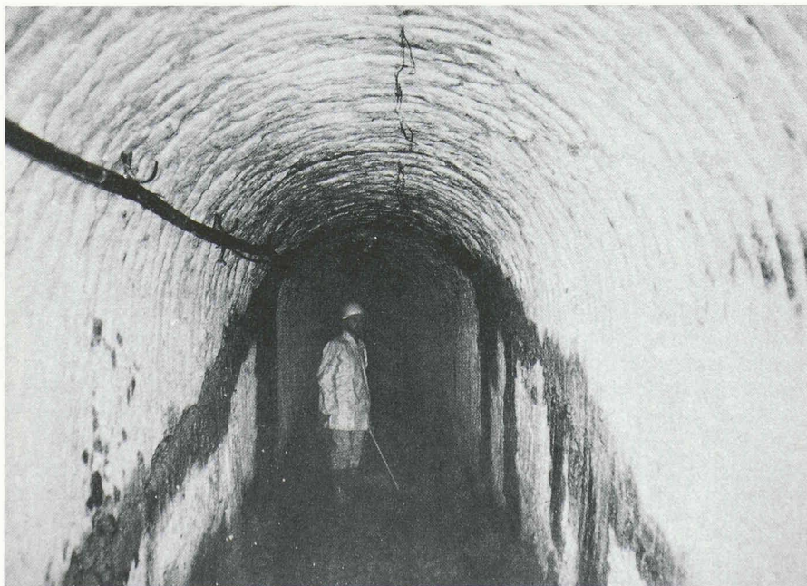
Fig. 4. — Suintements au niveau d'un interlit marneux dans le séquanien moyen à 435 m du portail nord.
