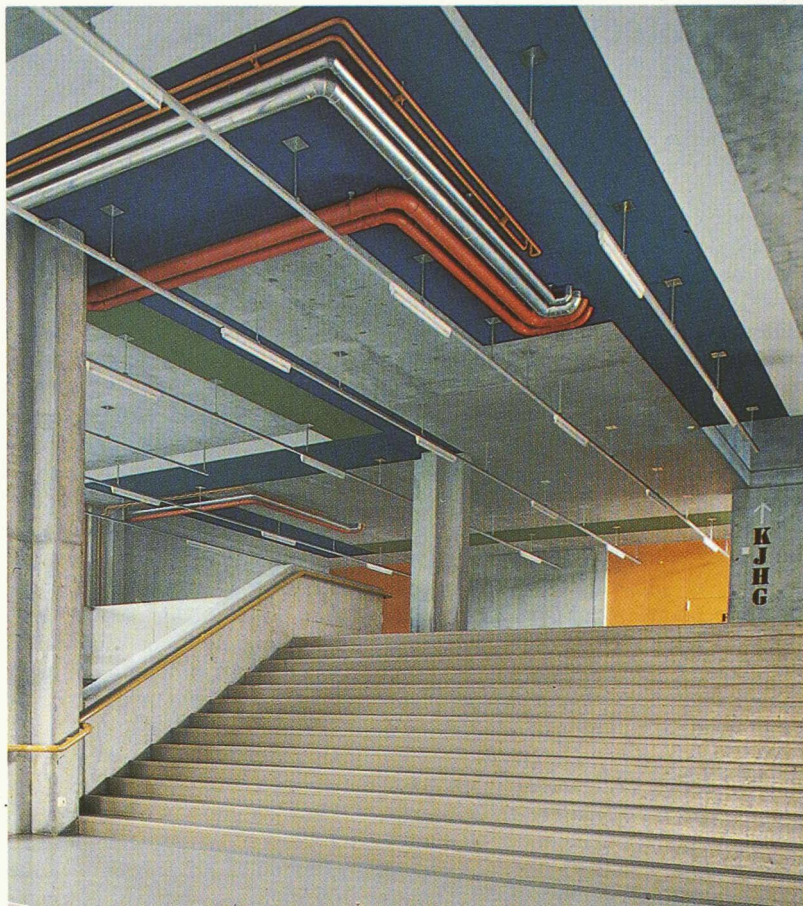
Montée du hall vers la mezzanine. Expression «néo-brutaliste» des gaines, tuyaux et tubes. La peinture balise les parcours. Les tons bleus construisent le ciel où filent les conduits.
