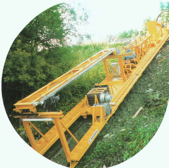
Cleuson-Dixence, Back-up pour tunnelier LOVAT
